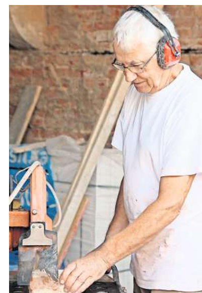
Gerhard Koch hilft fast täglich auf der Baustelle. Der Rentner schneidet derzeit die Steine für die Mauern.
